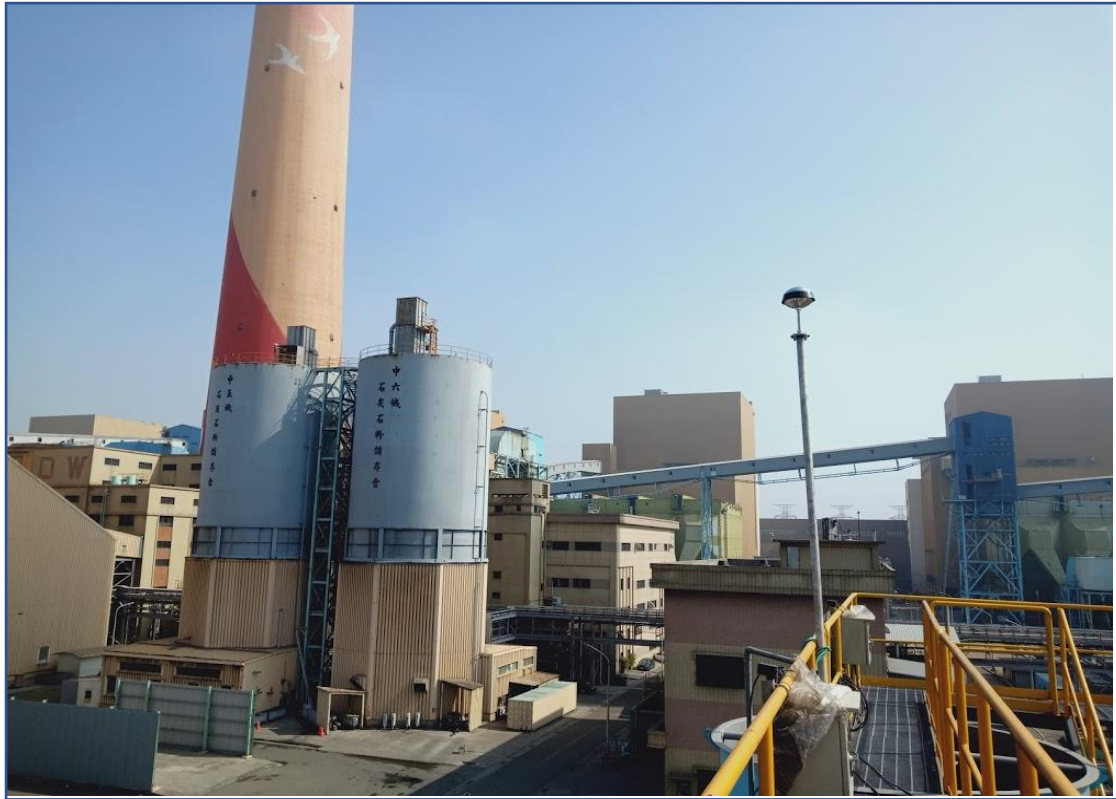
說明: 脫硫廢水場新設日本 PDCE 避雷針
