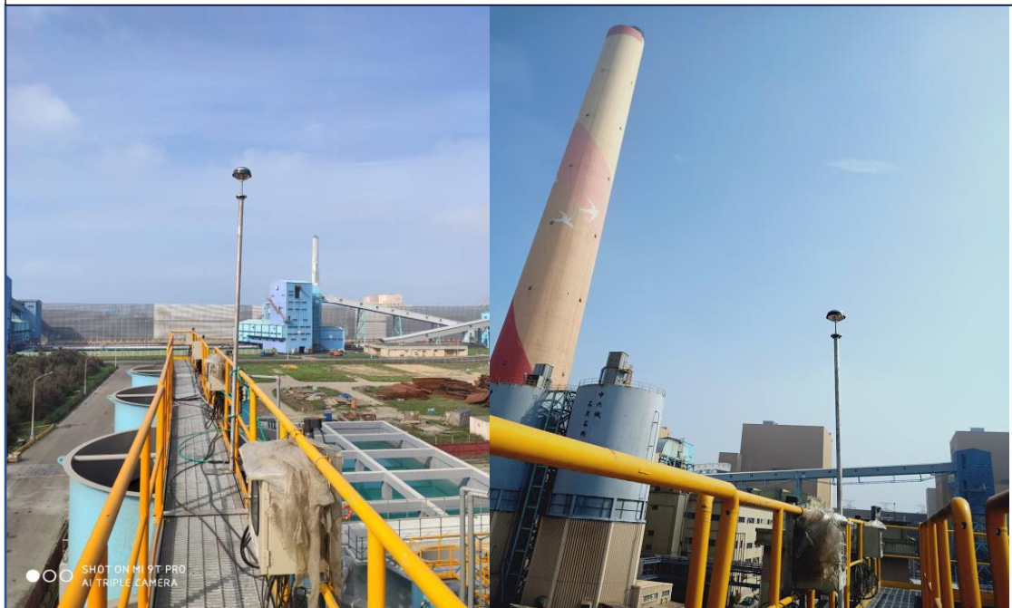
說明: 脫硫廢水場新設日本 PDCE 避雷針
